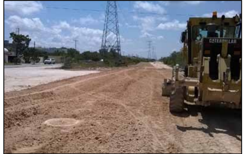
Con inversión de 17.9 millones de pesos la Sintra construye y pavimenta la primera etapa de un nuevo cuerpo vial, que creará una ruta alternativa para conectar el centro urbano de Cancún y una importante zona de colegios y universidades con la delegación de Alfredo V. Bonfil.
