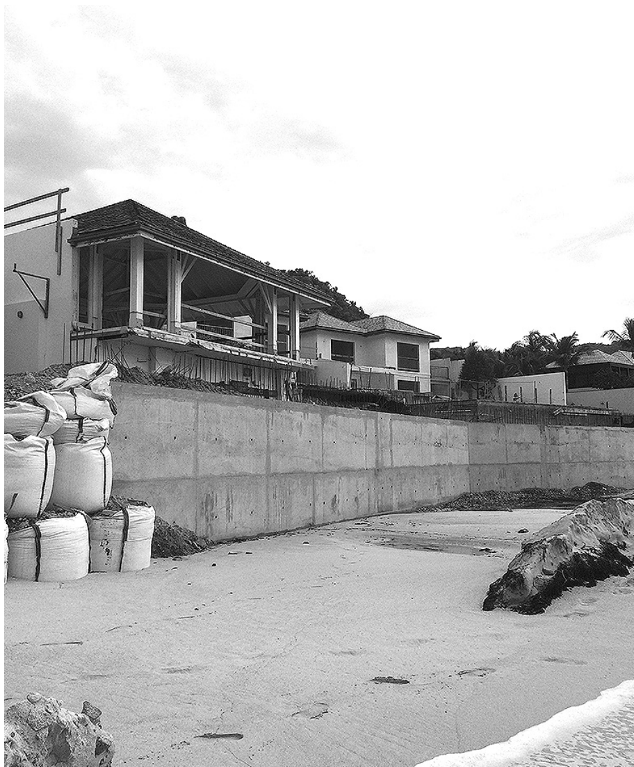
Les bâtiments meurtris par l'ouragan Irma désormais protégés par des murs.
